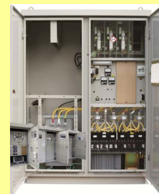
高圧受電設備
