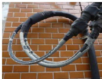
紫外線により絶縁体が破壊した例
