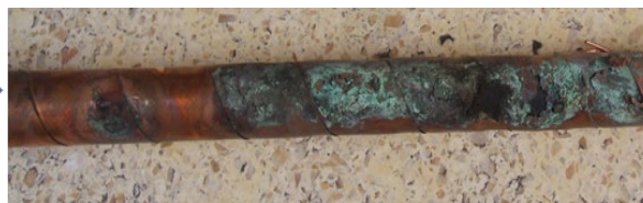
浸水により銅テープが腐食した例
