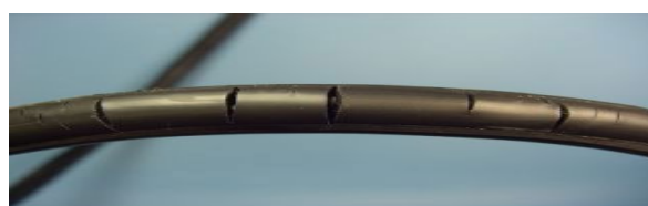
熱によりシースが硬化し割れた例
