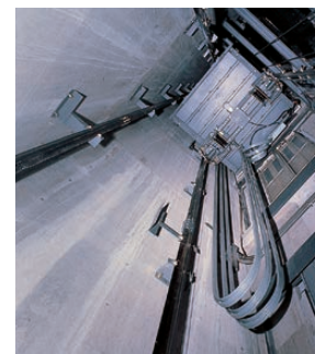
エレベータ用ケーブル
