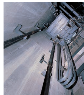
エレベータ用ケーブル
